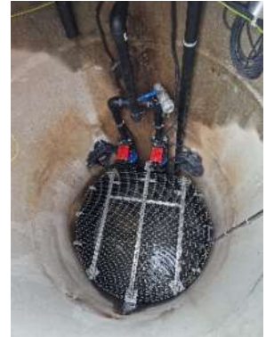
Abbildung 43: Installationen im Pumpschacht
