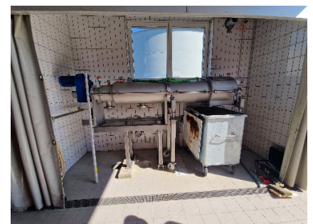
Abbildung 6: Neue FSM Schlammsiebung
