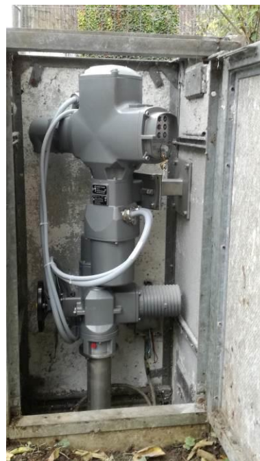
Abbildung 8: Neuer Regelschieber RB Verzinkerei
