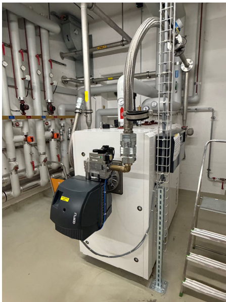
Abbildung Gasheizung mit Biogasbrenner
