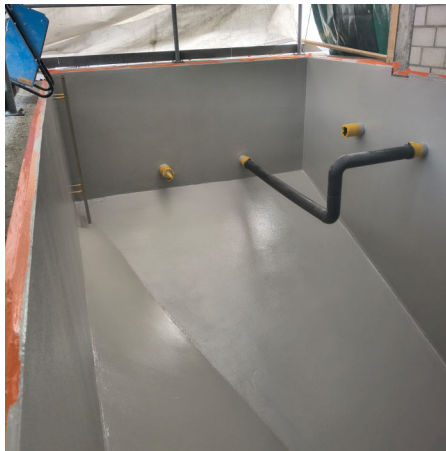
Abbildung Zentratstapelbehälter Neubeschichtung
