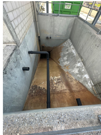
Abbildung Zentratstapelbehälter vor Neubeschichtung
